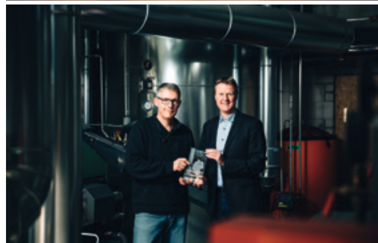
Preiswürdig: Klimamanager Dirk Nolkemper (links) und Bürgermeister Dirk Speckmann präsentieren die neue auf Holzhackschnitzel basierende Heizungsanlage sowie den u.a. dafür erhaltenen Preis.
