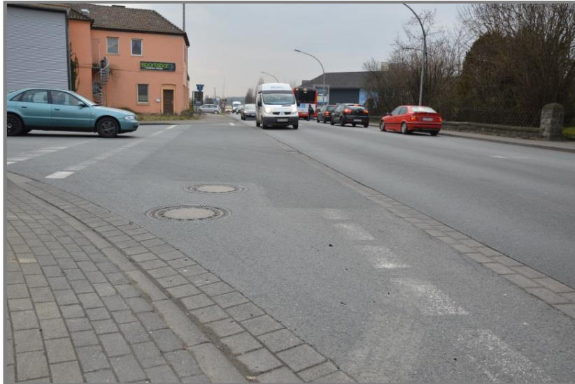
Abbildung 9: Stark verblichene Markierungen im Bereich Bahnhof an der Versmolder Straße
