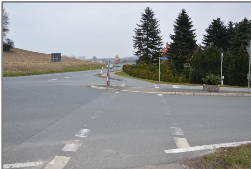
Abbildung 8: Stark verblichene Markierungen im Bereich der Kreuzung Bahnhofstraße / Unter der Burg
